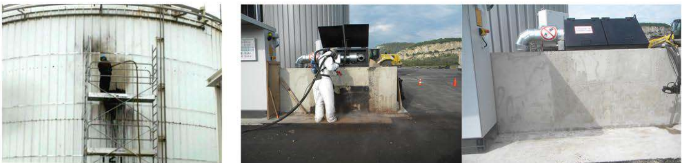
Nettoyage cryogénique d'une fuite de fuel lourd, fuite dans une unité de dépotage
