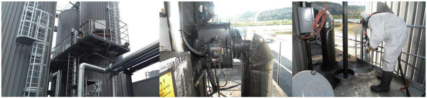
Nettoyage cryogénique d'une fuite de 2000 litres d'émulsion
